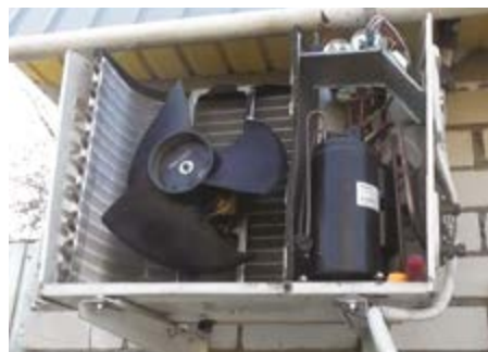
Intercambiador y compresor
