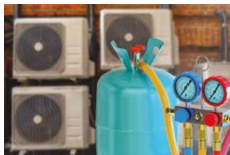
Comprobación de la presión del gas
