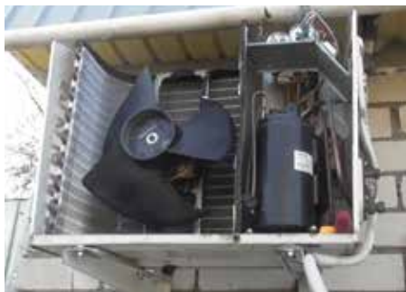
Échangeur et compresseur
